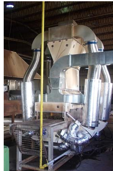
Fig. 4 . Imaginea Instalatiei de recuperare cu ejector montata
